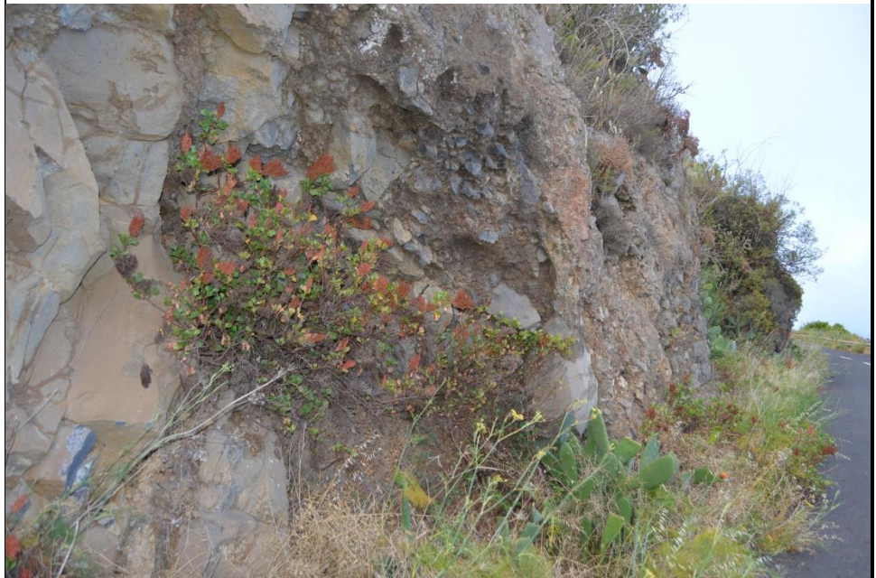
Foto 2. Aspecto de la falla de San Andrés en la carretera de San Andrés a Tiñor. A la izquierda (Norte) aparecen coladas basálticas sin deformar. A la derecha (Sur) se observa una brecha de falla procedente de la deformación frágil (rotura y trituración) de la colada. Esquema del LIG.
