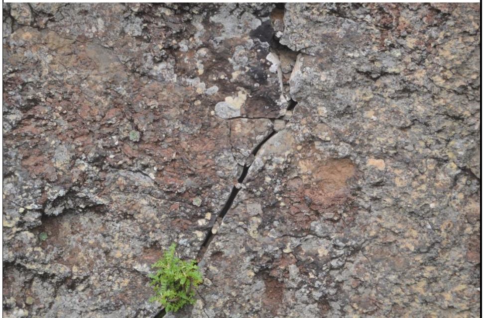
Foto 4. Detalle de la Fotografía 3. Las diaclasas están muy abiertas, lo que pone en peligro la estabilidad del dique.
